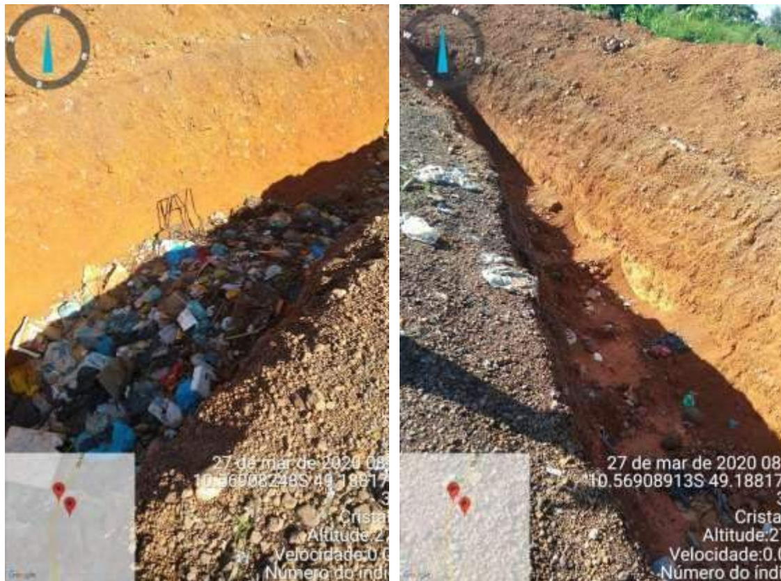
Figura 17: Valas abertas para recebimento de resíduos sólidos Fonte: Prefeitura Municipal de Cristalândia – TO, 2020
