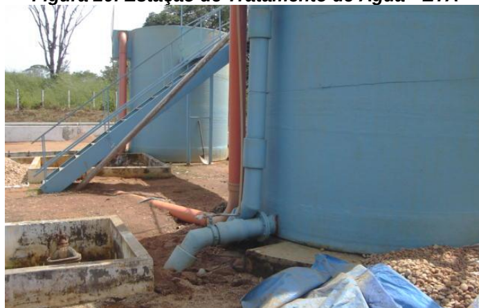
Figura 20. Estação de Tratamento de Água - ETA
