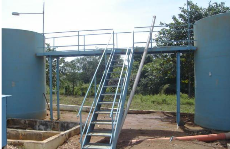
Figura 21. Estação de Tratamento de Água - ETA
